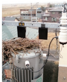
電柱に作られたカラスの巣
