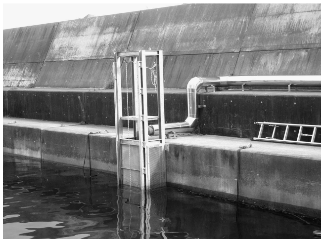
海藻等の流入防止対策後の取水口
