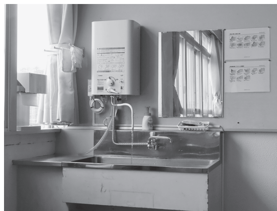
教室内に設置している電気温水器 (福島小学校)
