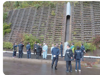
擁壁に覆われている漏水現場
