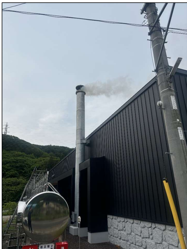
煙発生状況写真（5月末撮影 運転開始時）
