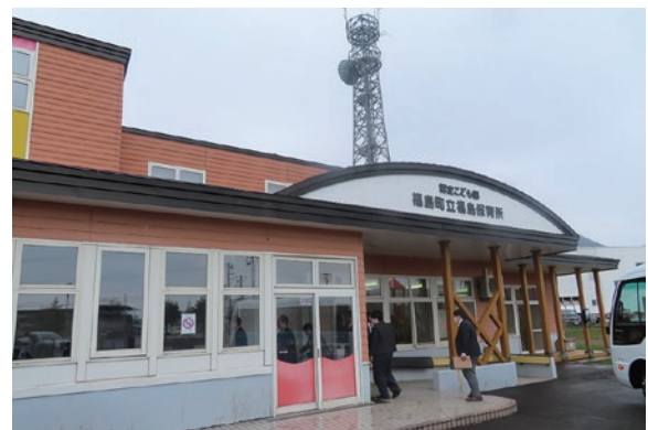
建築から23年が経過し、老朽化が目立つ
