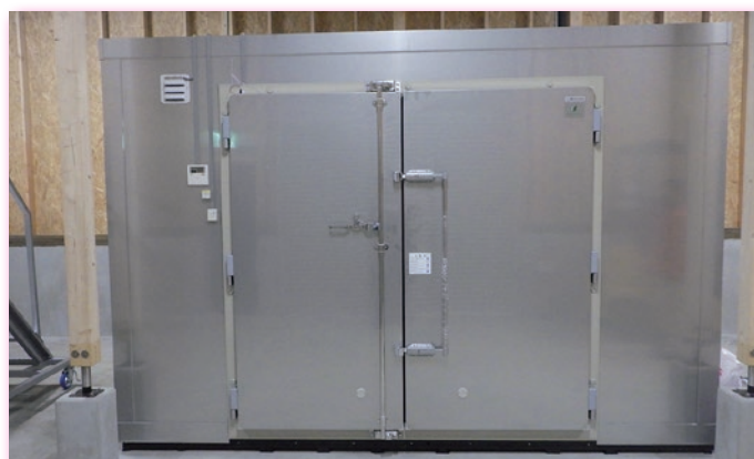
▲保管用冷凍庫
